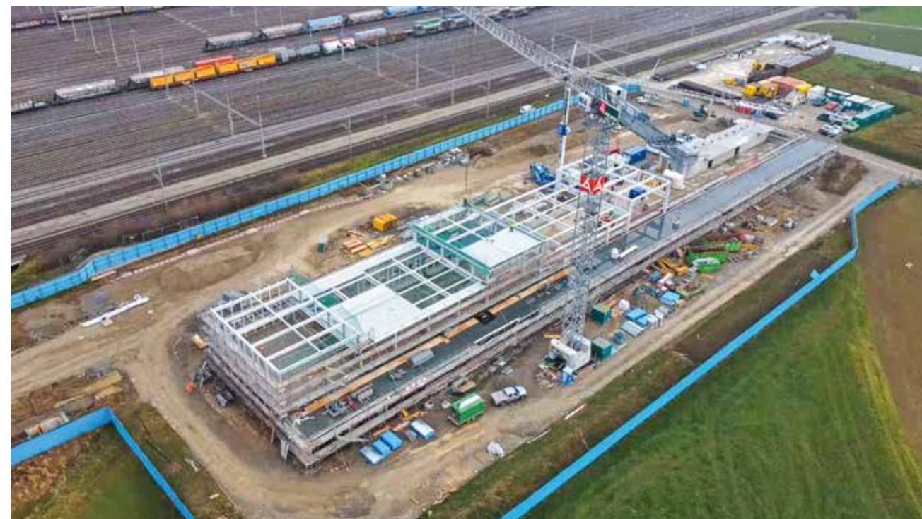
Die Luftaufnahme zeigt den beeindruckenden Massstab der Stahlkonstruktion im Bauprozess. Das Werkstattgebäude ist 22 m x 145 m gross, mit einem Stützenraster von 6 m. Der Bau steht neben den Gleisen des Rangierbahnhofs Limmattal auf der noch grünen Wiese.
